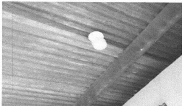
Foto 3: Sistema Electrico, ya instalados en perfectas condiciones.
